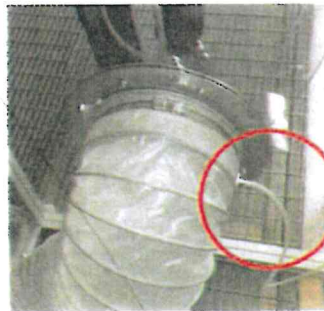
Raccord de piquage du flexible dans la gaine de ventilation
