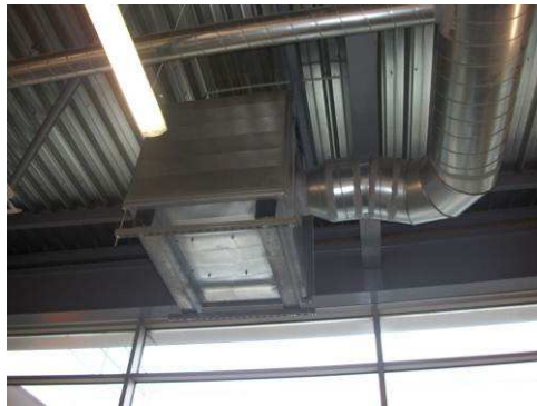
Extracteur sous toiture
