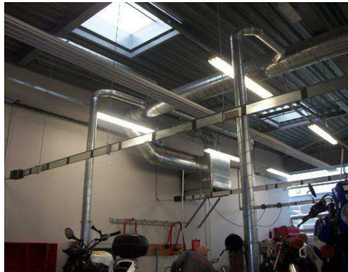
Extracteur sous toiture
