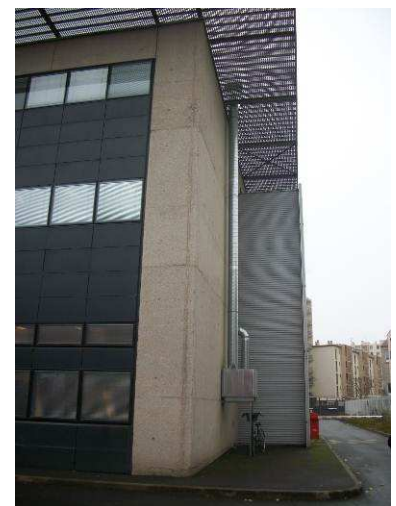
Extracteur en façade
