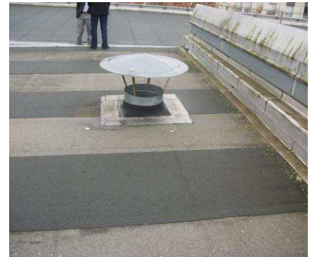
Cheminée d'extraction en toiture
