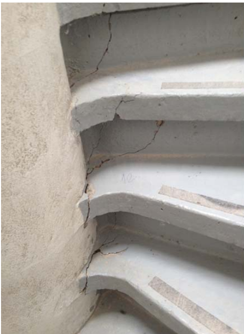
Vue du milieu de volée qui pose problème
